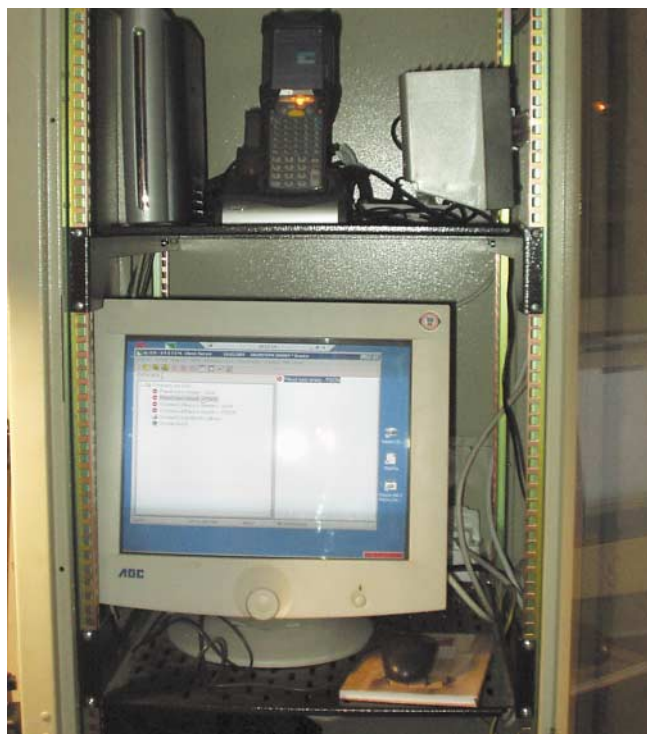
Obr. 3: Implementovaná skříň s terminálem
